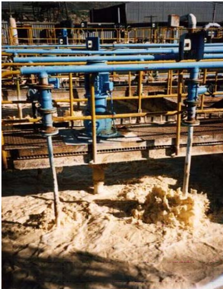
Figura 50. Sistema de aireación en una planta de tratamiento de aguas ácidas con cal.
